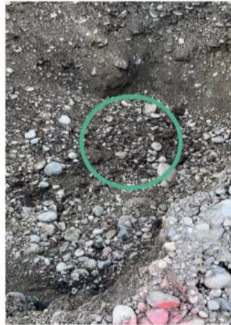
La fouille lors de la coupure avec la terre effondrée qui masque les câbles
